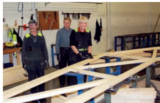
▲ Erkki Ikäläinen (vas.), Matti Martikainen ja Aivi Raudberg kokoamassa kattoristikkoa hallissa, josta Sepan tarina alkoi vuonna 1982.
